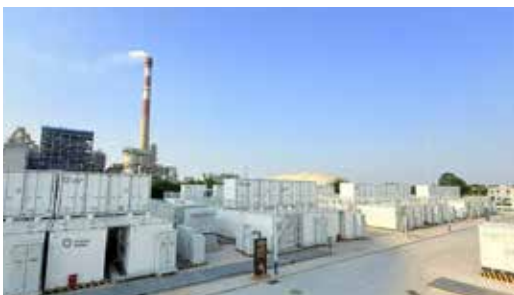
河北某电厂储能项目
