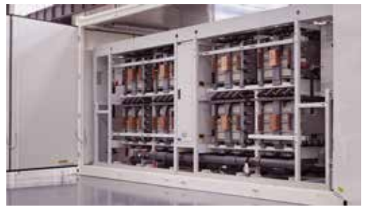
广州高新区能源研究院储能电站项目
