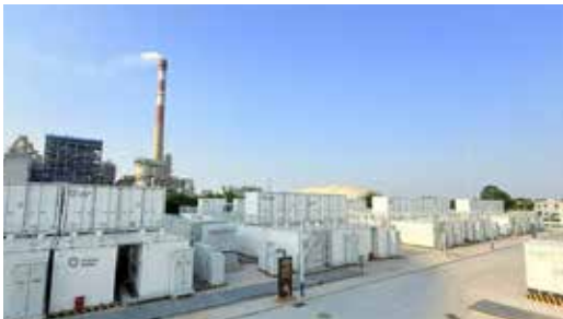
河北某电厂储能项目
