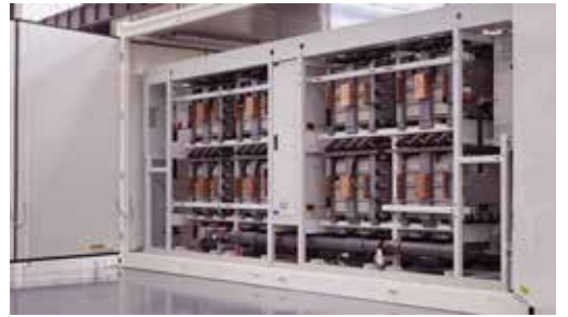
广州高新区能源研究院储能电站项目
