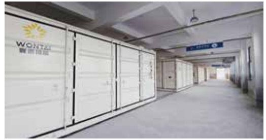
温州宏丰电工合金 储能电站项目
